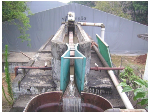
Figura 29 – Tratamento preliminar do esgoto bruto
