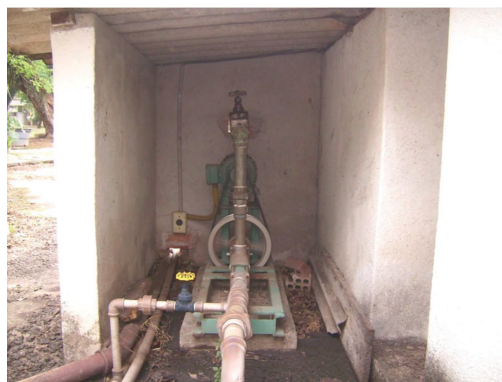
Figura 30 – Bomba de transferência de esgoto pré-tratado.
