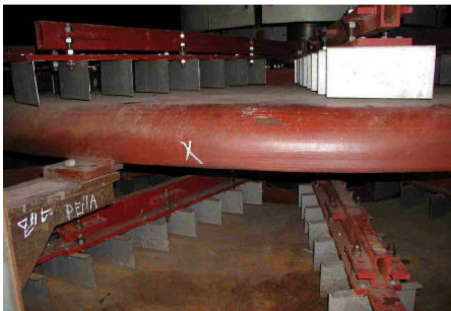
Figura 4.5 – Bandejas de secagem e raspadores de lodo do secador de lodos da ETE São Miguel.
