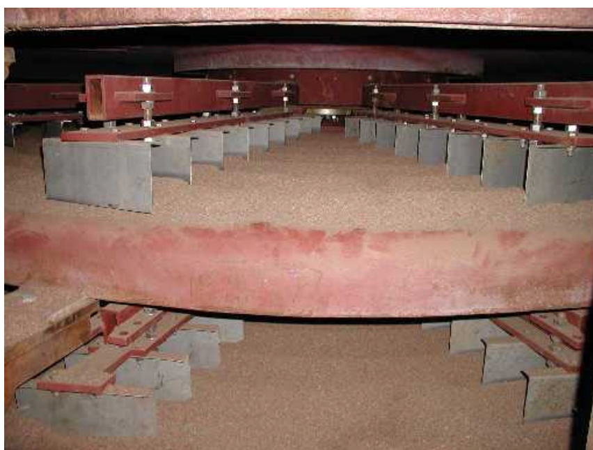
Figura 4.3 – Vista interna do secador de lodos da ETE São Miguel.
