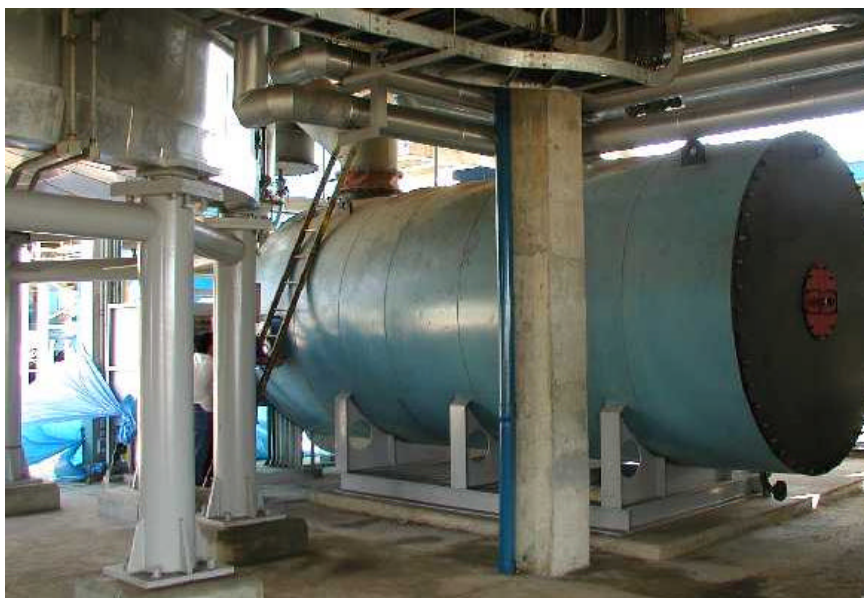
Figura 4.6 – Caldeira de óleo térmico do secador de lodos da ETE São Miguel.
