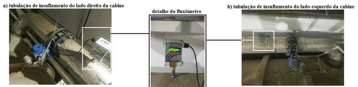
Figura 4.17 – Pontos de medição da vazão do sistema de ventilação por mistura
