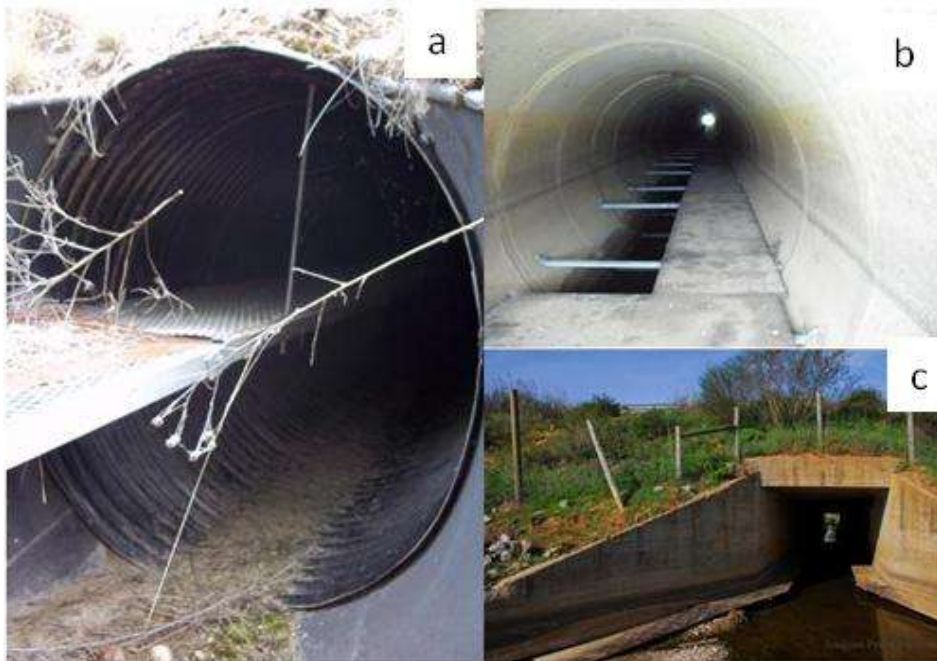
Figura 18: Exemplos de tubos e caixas de drenagens adaptados com passarelas: (a) passagem redonda de tubo Armco, Montana (EUA), (b) passagem redonda de concreto, Alentejo (Portugal), (c) Passagem quadrada de concreto, Vendas Novas (Portugal). (Foto: Fernanda Delborgo Abra.).
