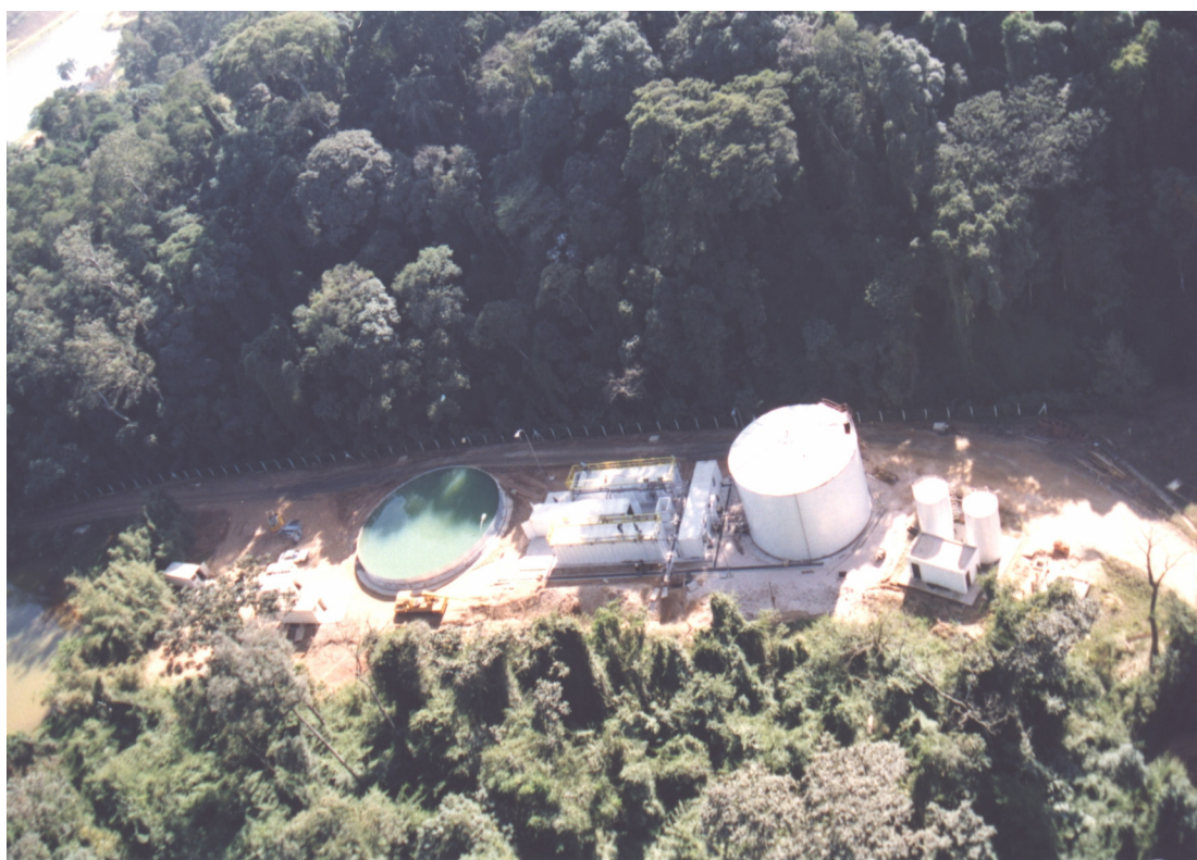
Figura 10: Estação de tratamento vista aérea.
