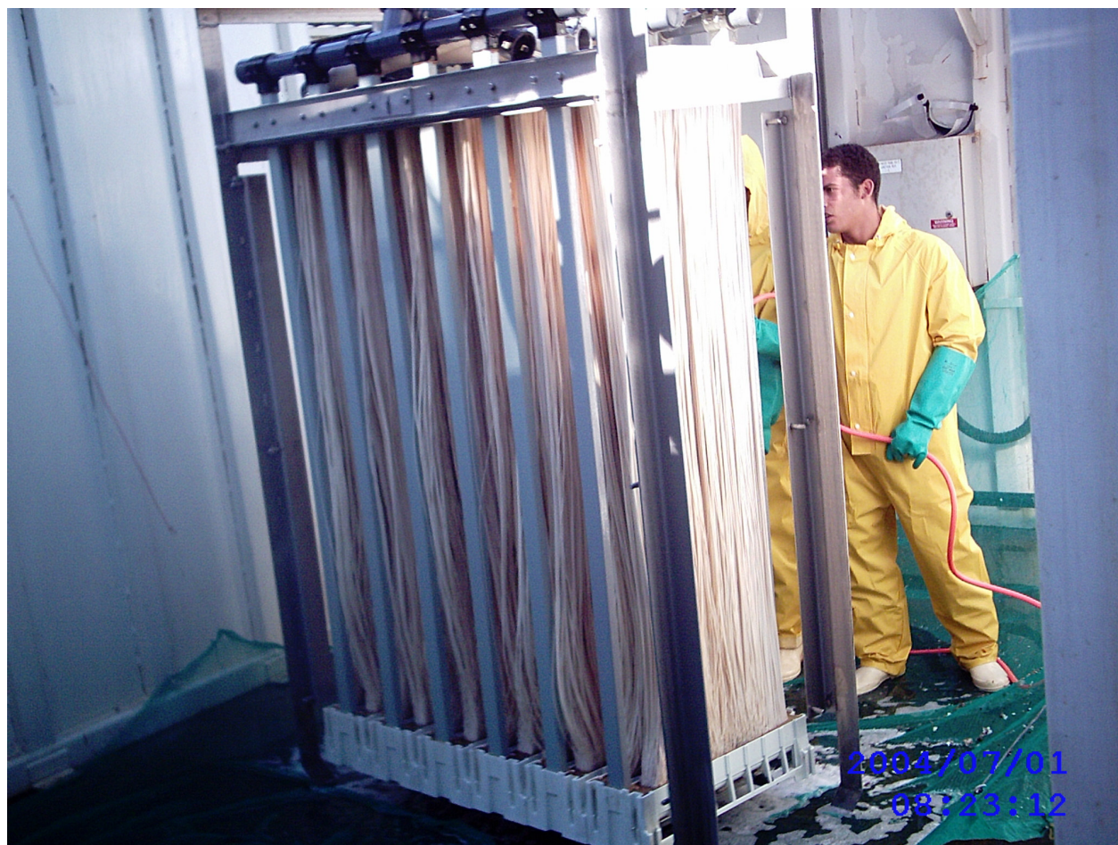
Figura 6: Cartucho com 6 módulos de membranas do empreendimento sendo lavados.
