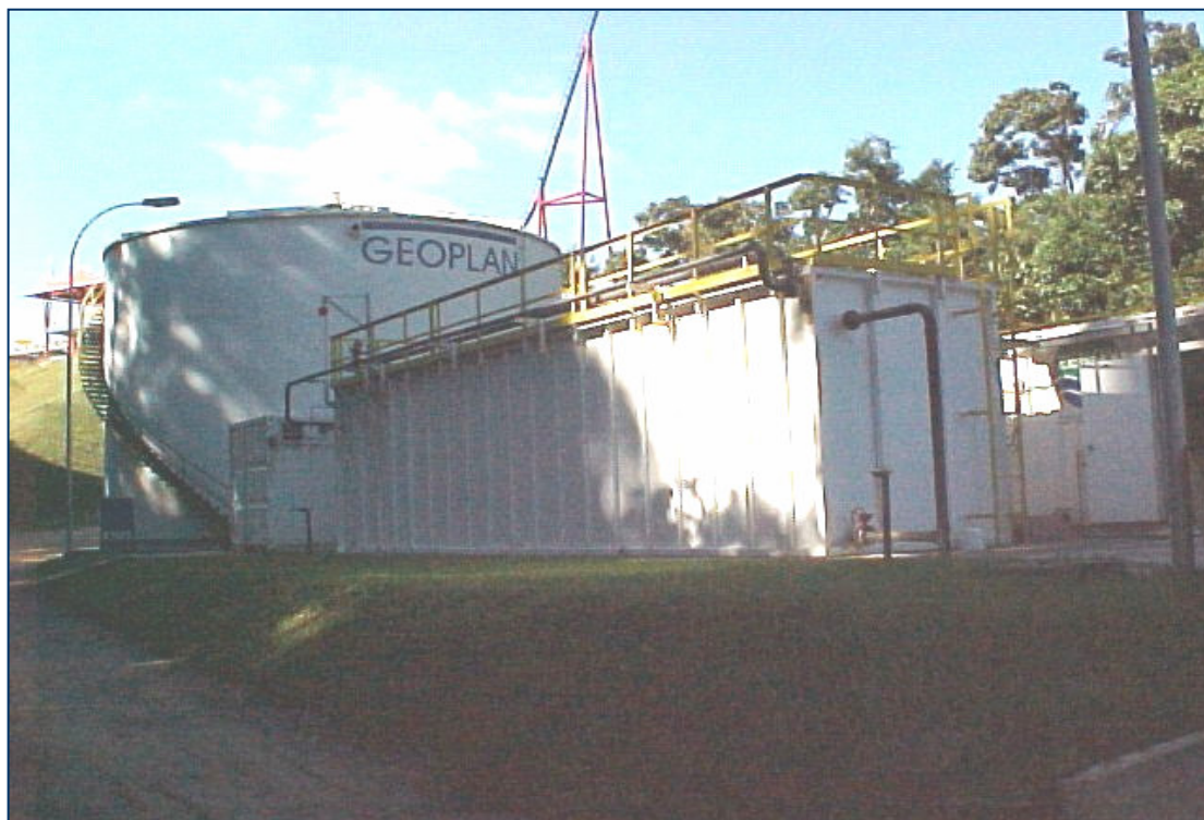
Figura 9: Container que abriga o sistema de membranas
