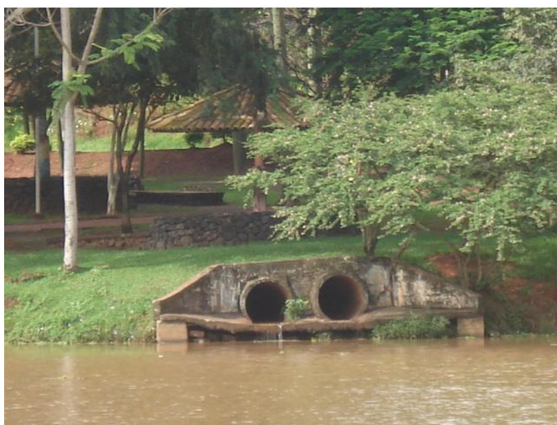
Figura 8. Ponto 5 – Lançamento de esgoto (Foto Daniela; 2009)
