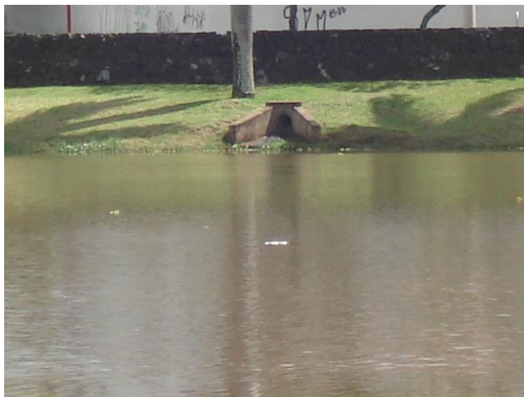
Figura 5. Ponto 2 – Lançamento de esgoto (Foto Daniela; 2009)
