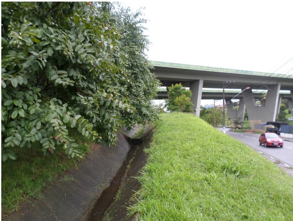
Figura 30: Exemplo de escoamento superficial concentrado intencional sobre caminho de drenagem artificial construído sobre o patamar de aterro relacionado a Rodovia dos Imigrantes. Fotografia: Eduardo Luiz Morari
