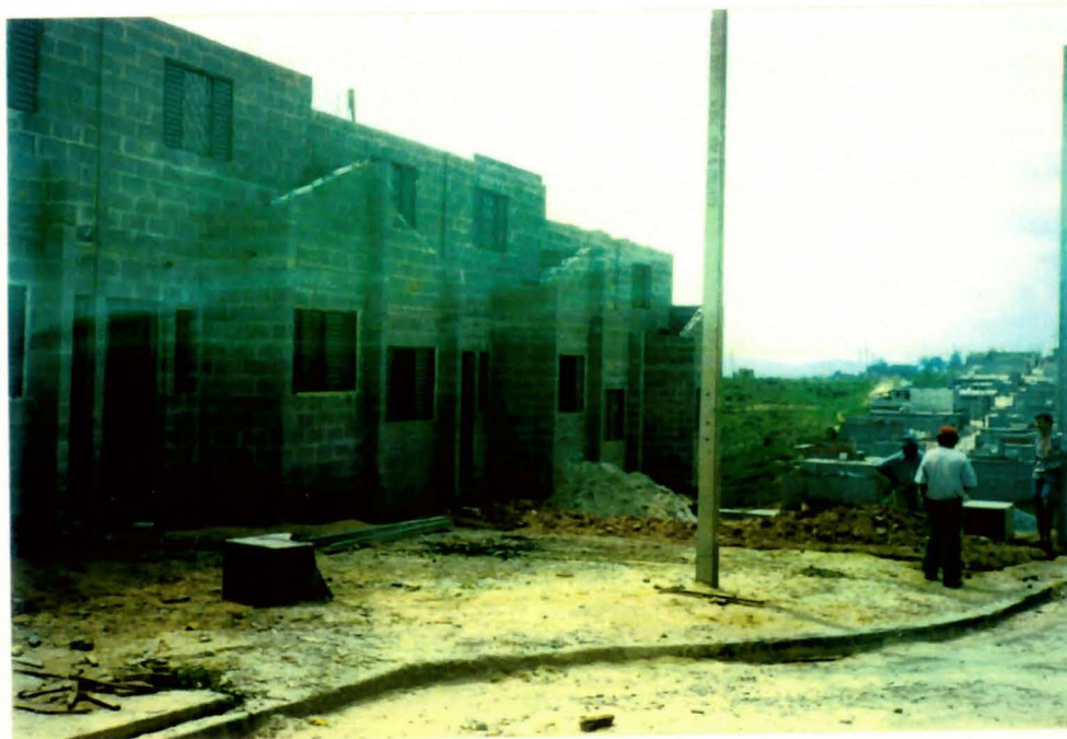
Foto 12 - Jardim Miriam III. Construção paralisada por falta de verba (foto de 1993).
