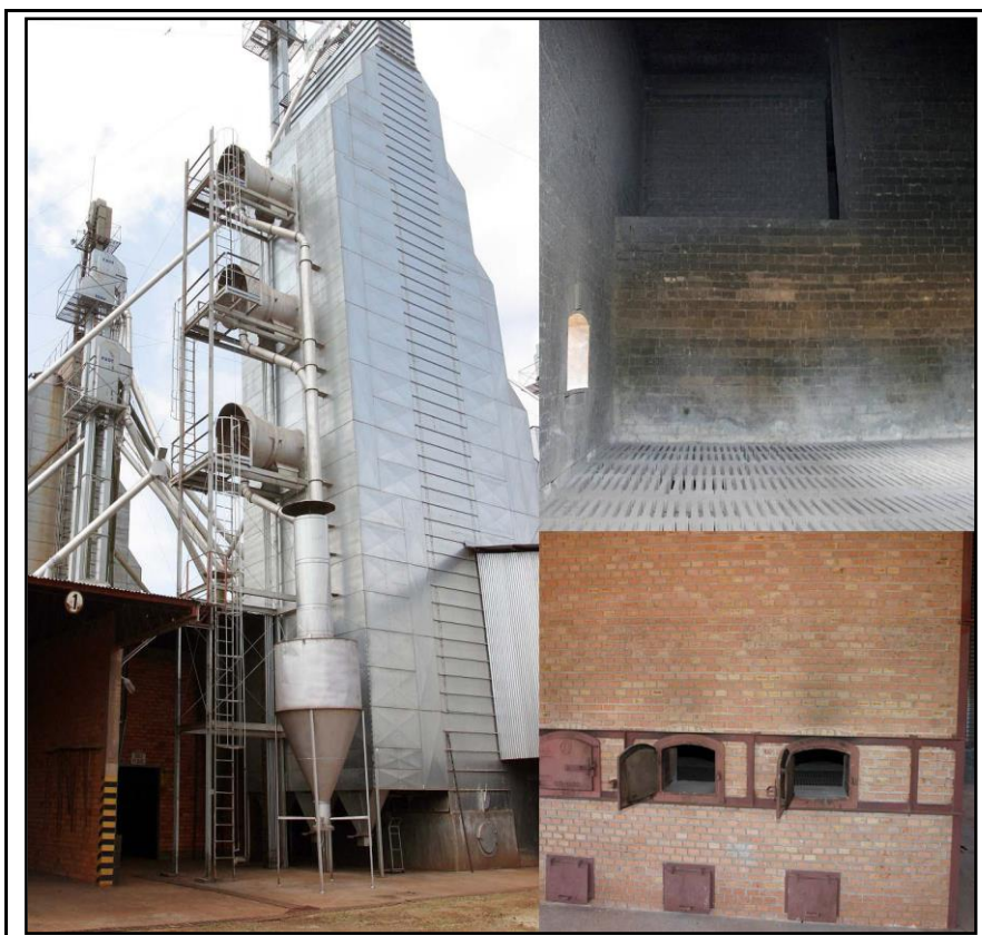
Foto nº 15. Sistema de secagem de produtos - Secador capacidade 100 t/h; - Câmara Anti-fagulha fornalha –visão interna; - Fornalha à lenha–vista externaSecador. Fonte: COAMO, 2010.
