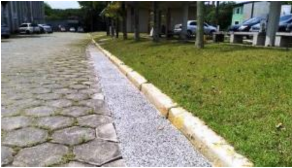
Figura 37: Protótipo de sarjeta permeável no estacionamento da ABCP - Associação Brasileira de Cimento Portland. Foto: ABCP (2020).
