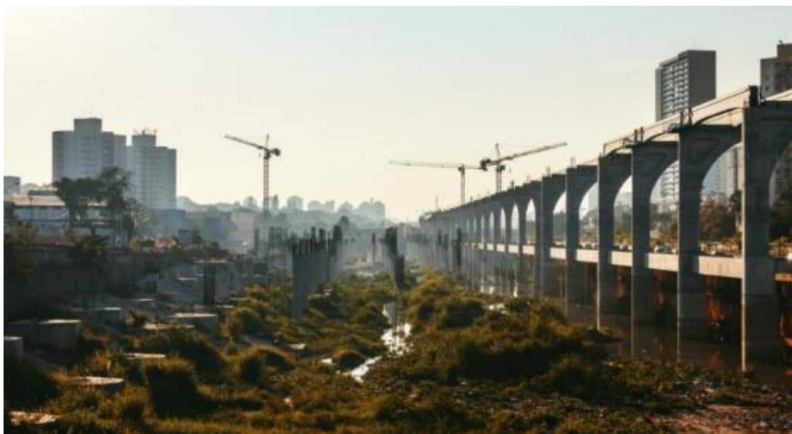
Figura 26: Construção do pátio de manobras do monotrilho da Linha 17 - Ouro do Metrô (2019)
