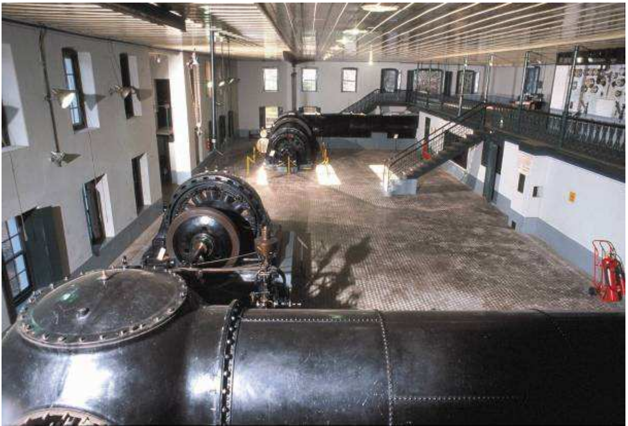
Fig. 4.8: Interior da casa de máquinas visitável da Usina Hidrelétrica de Corumbataí (rio Corumbataí, 2,13 MW), sede do Museu da Energia em Rio Claro-SP, 2001
