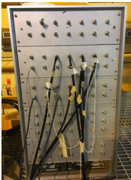
Figura B.12 - Painel de entrada de sinais do núcleo do reator
