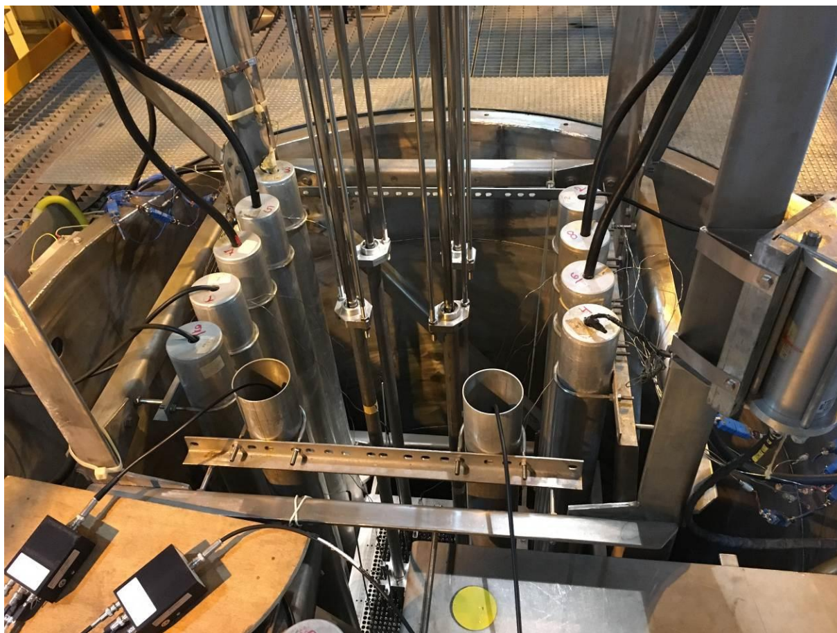
Figura B.2 - Tubos de aço inoxidável ao redor do núcleo do reator onde os detectores são inseridos para evitar o contato com a água
