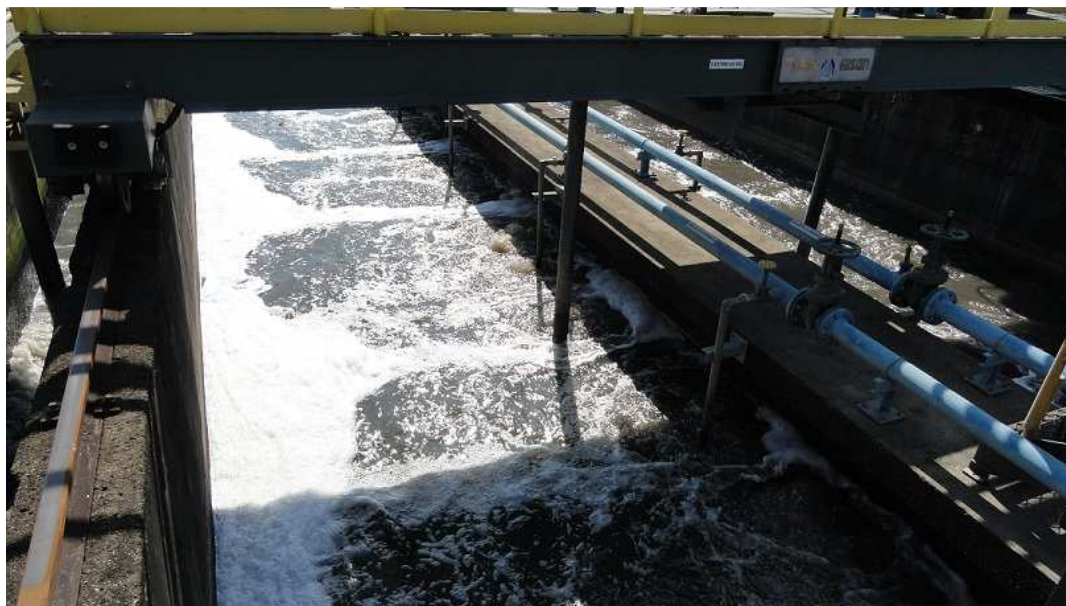
Figura 5.3 - Tanque de areia aerado
