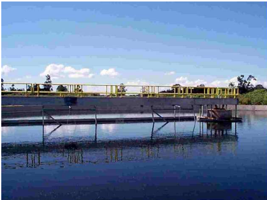
Figura 3.9 - Decantador Secundário da Estação de Tratamento de Esgoto Caiçara - Fonte: BDT@ (2011)
