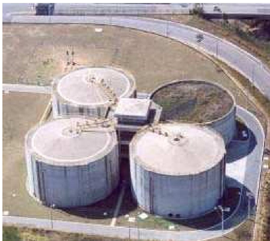
Figura 3.10 - Digestores Anaeróbios da Estação de Tratamento de Esgoto Arrudas - Fonte: COPASA (2011)
