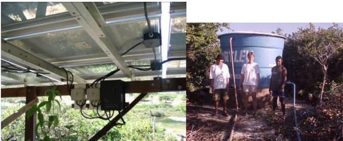
Figura 53 - Caixa de conexões, inversor e reservatório de água
