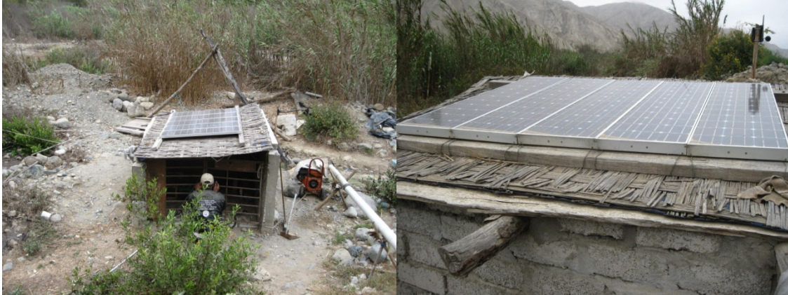
Figura 35 - Gerador fotovoltaico de 250 Wp
