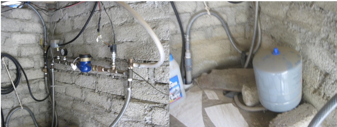
Figura 38 - Cabeçal de irrigação com sistema de pressurização e filtragem
