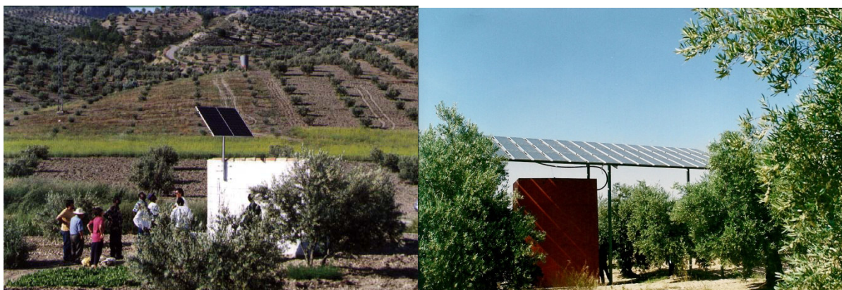
Figura 17 - Sistemas fotovoltaicos de bombeamento utilizados para irrigação de oliveiras em Jaén, Espanha
