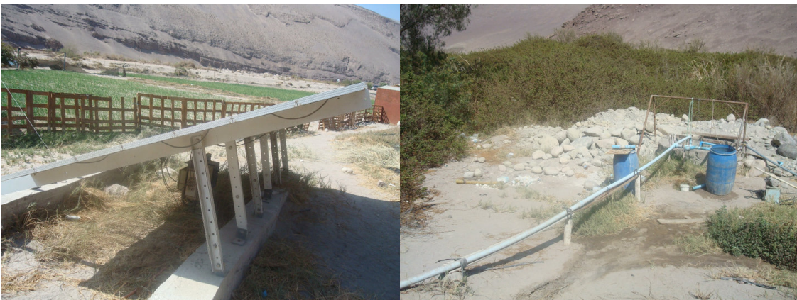
Figura 29 - Sistema fotovoltaico de irrigação sem reservatório de água
