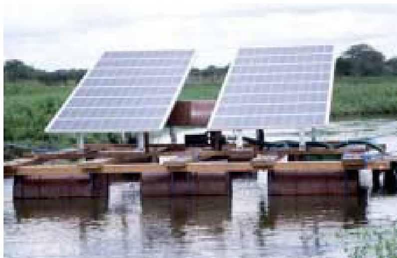
Figura 41 - Sistema fotovoltaico de bombeamento sobre base flutuante instalado em Capim Grosso
