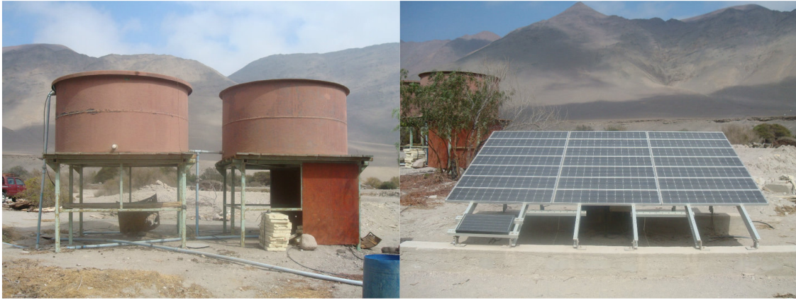
Figura 28 - Sistema fotovoltaico de irrigação com tanque elevado
