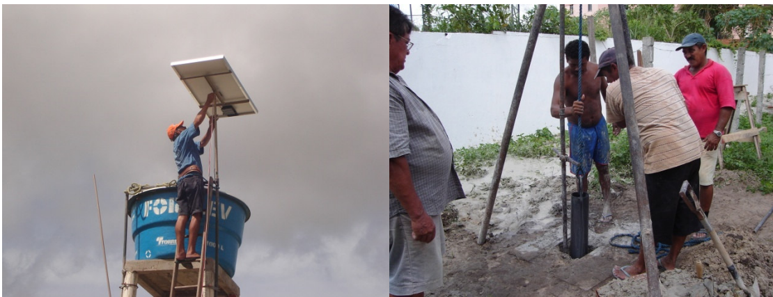
Figura 49 - Instalação do sistema fotovoltaico de irrigação no Centro de Referência em Agricultura Urbana Sustentável
