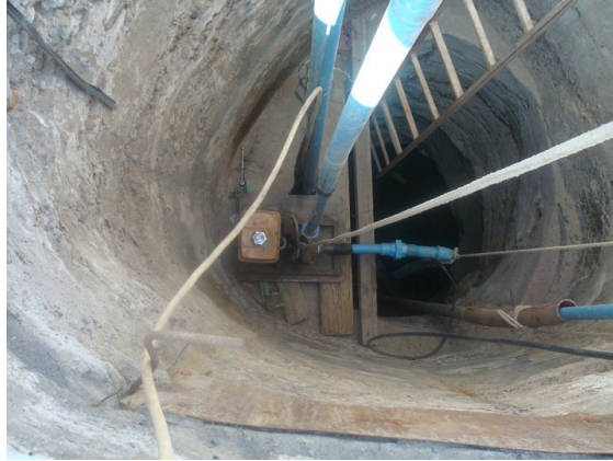
Figura 30 - Vista do poço do sistema sem reservatório com presença de um gerador diesel auxiliar
