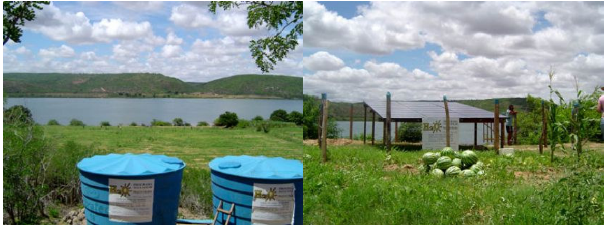
Figura 43 - Sistema fotovoltaico de irrigação instalado em Traíras (AL)
