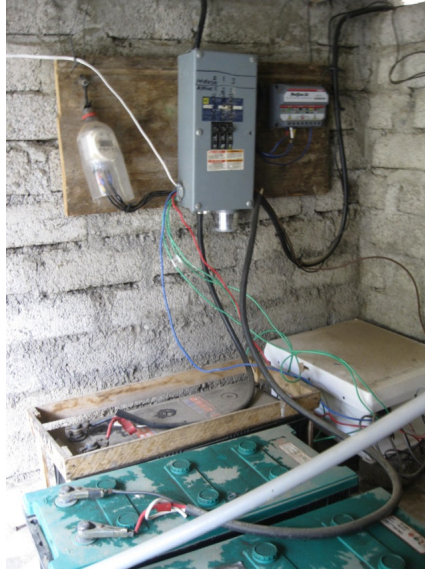
Figura 37 - Sistema de condicionamento de potência e baterias
