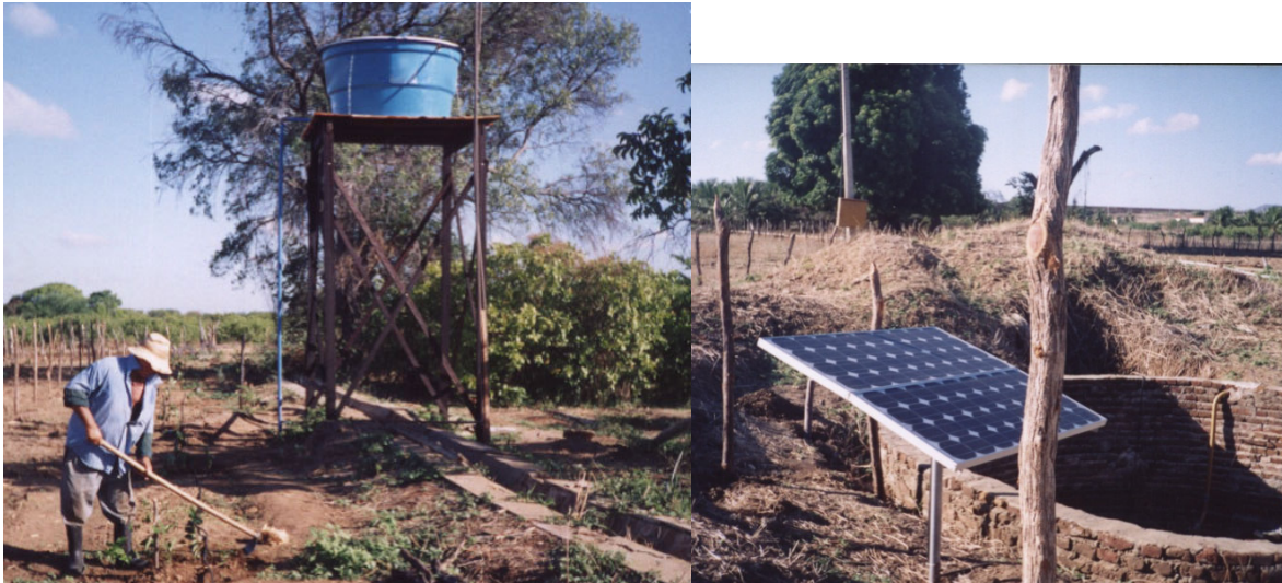
Figura 46 - Sistema fotovoltaico de irrigação instalado na comunidade de Condado (PB)
