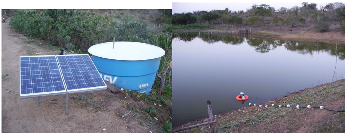
Figura 48 - Sistema fotovoltaico de irrigação instalado na comunidade Pintadas (BA) Fonte: (Arquivo gráfico do Projeto ADAPTA SERTÃO)
