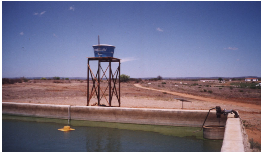
Figura 45 - Sistema fotovoltaico de irrigação instalado na estação experimental de Veludo, Itaporanga (PB)
