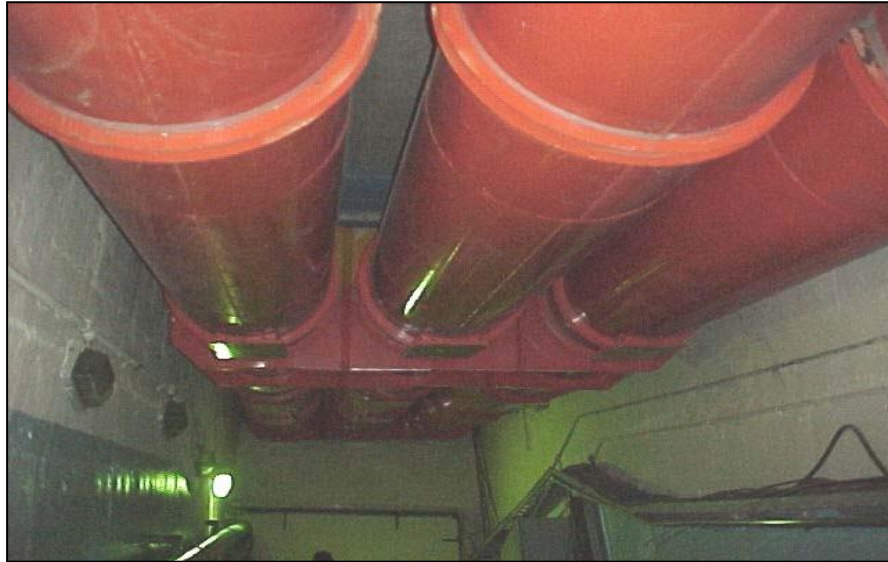
Figura 10 - Barramento blindado de fases isoladas - vista trifásica Fonte: VSPA (curso interno - 2002)
