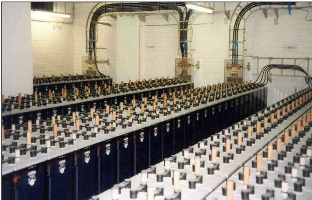
Figura 13 - Banco de baterias estacionárias Fonte: VSPA (curso interno – 2002)
