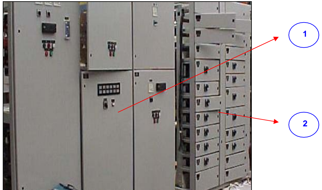
Figura 12 - CCM - vista geral Fonte: VSPA (curso interno – 2002)
