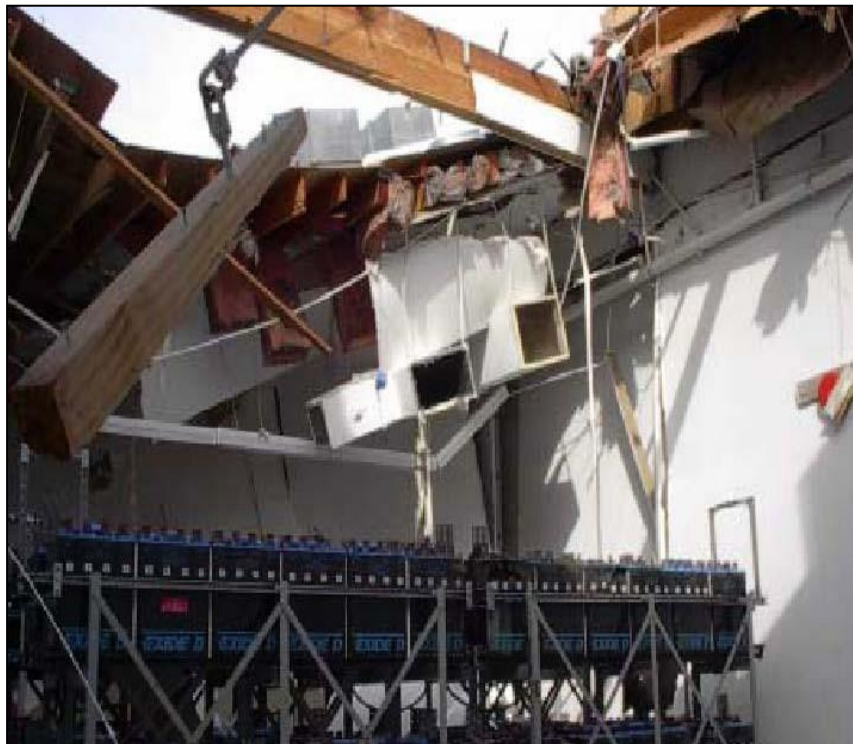
Figura 14 - Sala de baterias estacionárias com exaustão inadequada Fonte: VSPA (curso interno – 2002)
