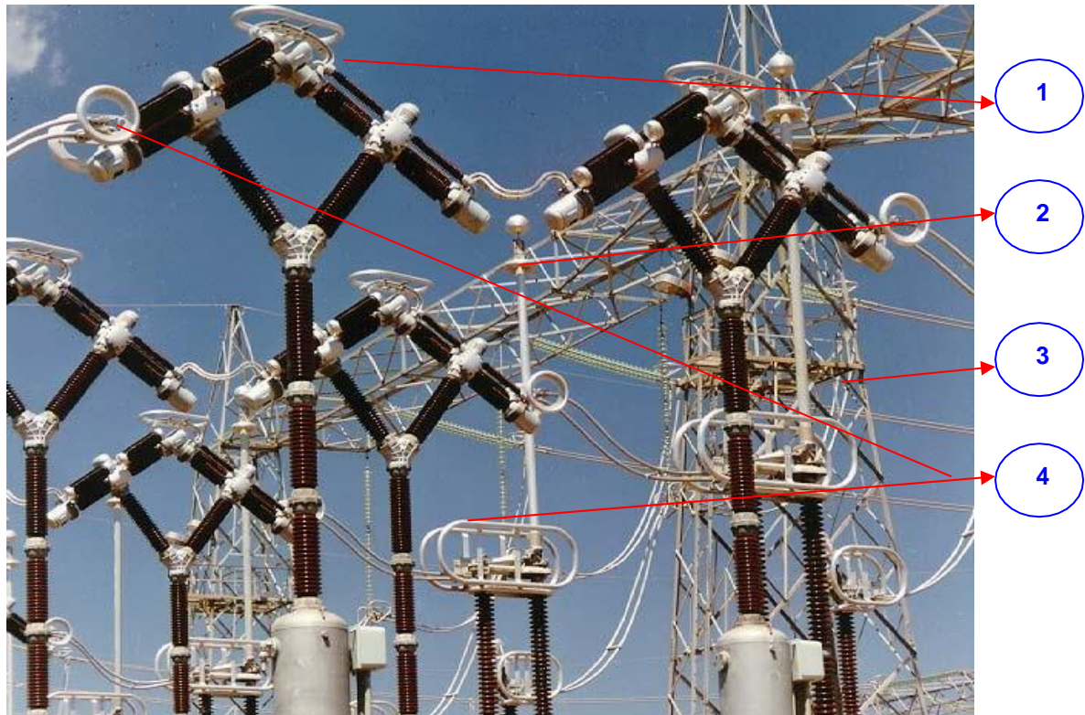
Figura 4 - Vista de equipamentos de uma subestação elétrica em alta tensão
