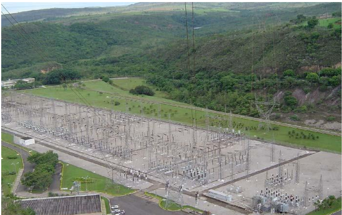
Figura 3 - Vista geral de uma subestação elétrica em alta tensão
