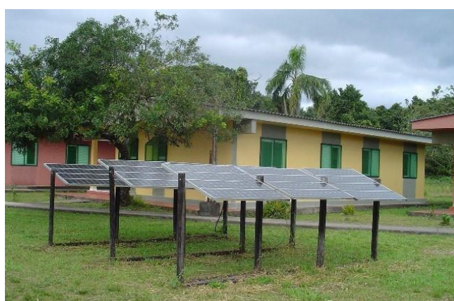
Figura 3.9 – Exemplo de sistema fotovoltaico do Perequê
