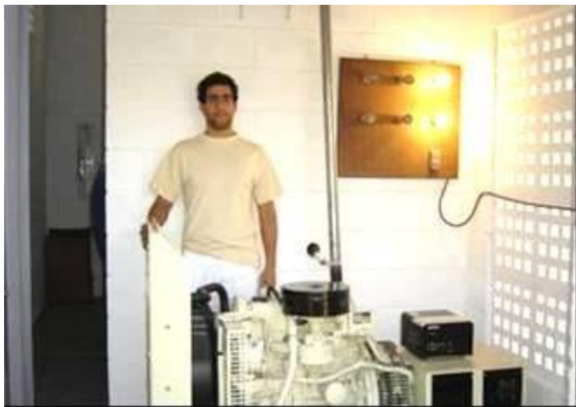
Figura 43. Grupo motor-gerador com painel de teste. Fonte: CENBIO, 2005h.
