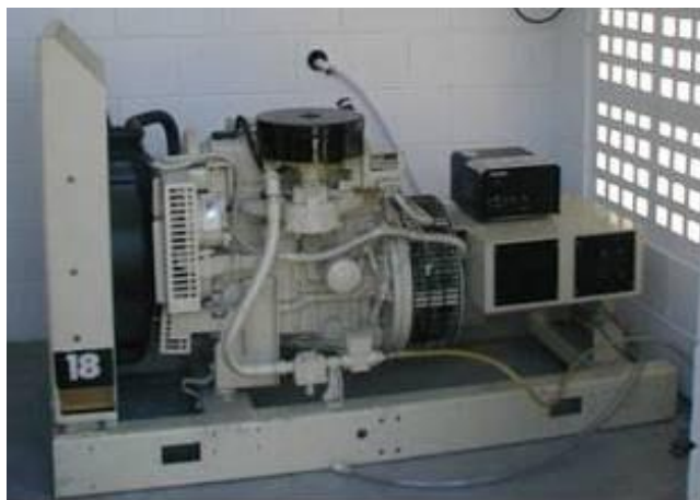
Figura 40. Grupo motor-gerador. Fonte: CENBIO, 2005h.
