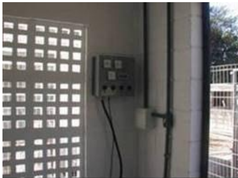
Figura 44. Painel de comando do grupo motor-gerador. Fonte: CENBIO, 2005h.
