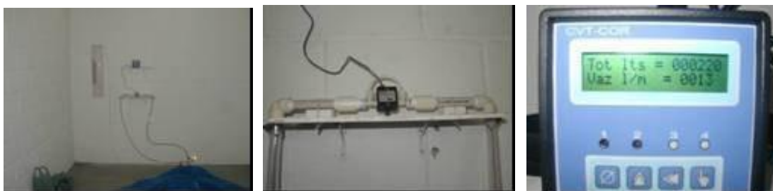
Figura 41. Fotos do medidor e totalizador de vazão de biogás instalados no abrigo. Fonte: CENBIO, 2005h.
