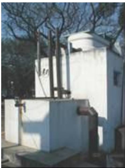
Figura 26. Tanque de acumulação do esgoto. Fonte: CENBIO, 2003c.
