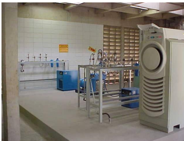
Figura 15. Instalação do projeto ENERGI-BIOG. Fonte: CENBIO, 2004e.
