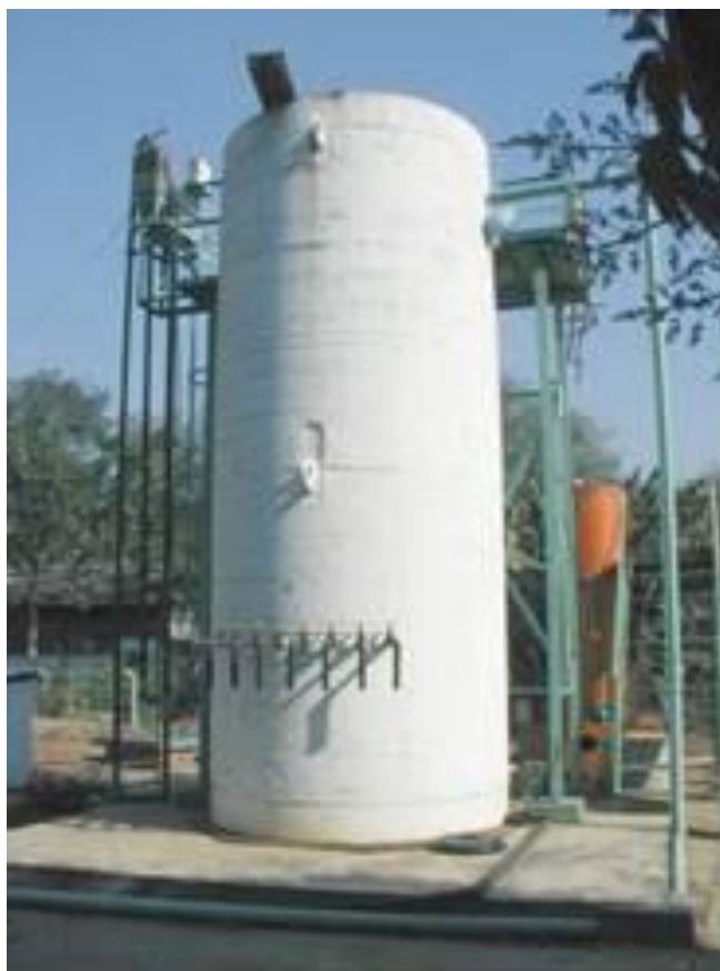
Figura 22. Biodigestor modelo UASB existente no CTH Fonte: CENBIO, 2003c.
