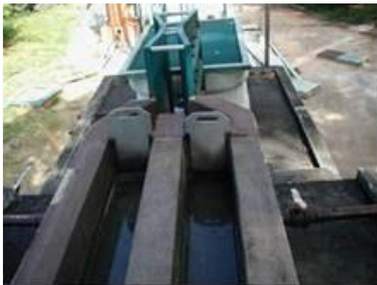
Figura 25. Calha Parshall. Fonte: CENBIO, 2003c.
