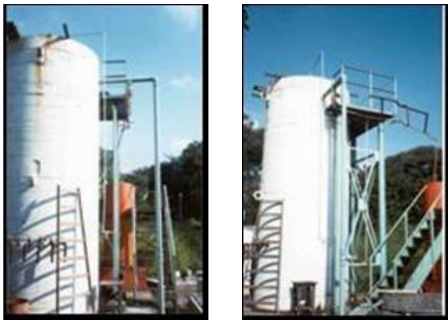
Figura 31. Fotos da tubulação de biogás instalada. Fonte: CENBIO, 2004g.
