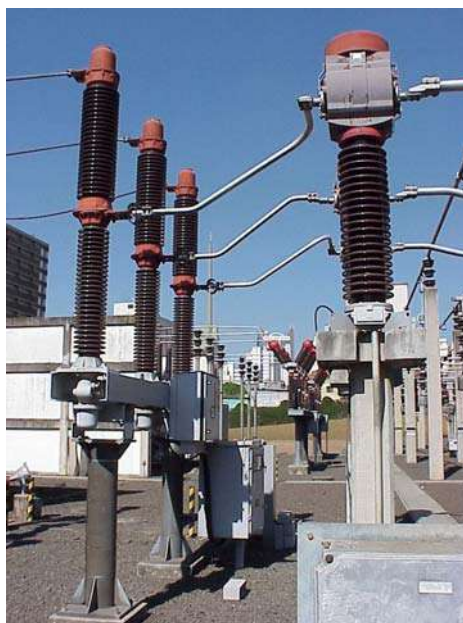
Figura 5.2: Disjuntor SF6 Siemens de 138 kV com comando hidráulico (CPFL SE Campinas Centro).
