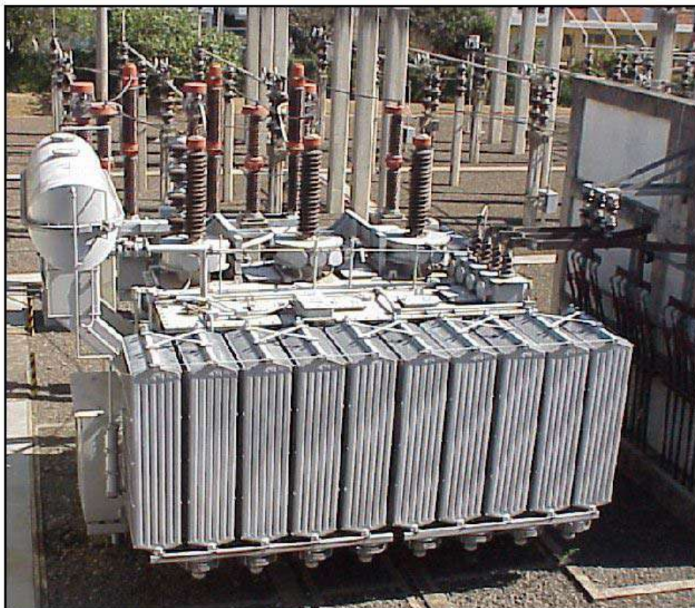
Figura 6.2: Transformador Monitorado (TR-3 Campinas CPFL) Potência 50 MVA e Tensão Nominal 138kV / 11.95kV.
