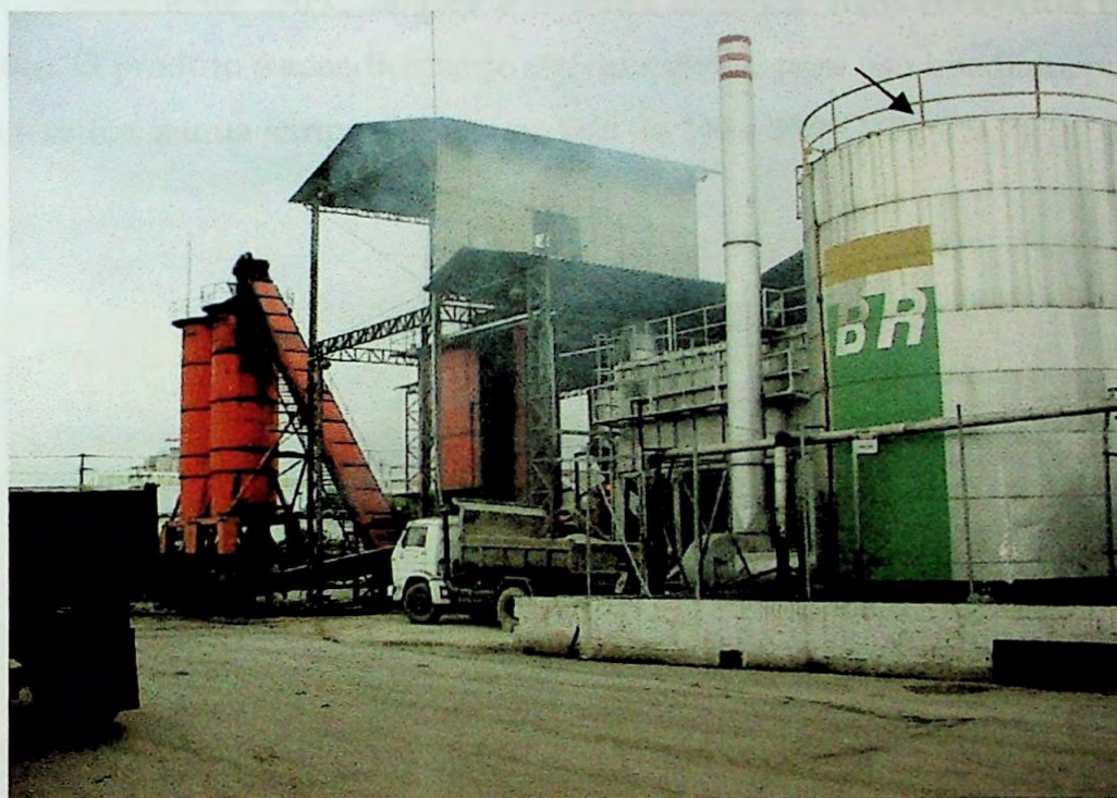
FIGURA 6 - Tanque isolado termicamente para o armazenamento do Cimento Asfáltico de Petróleo, distribuído pela Petrobrás
