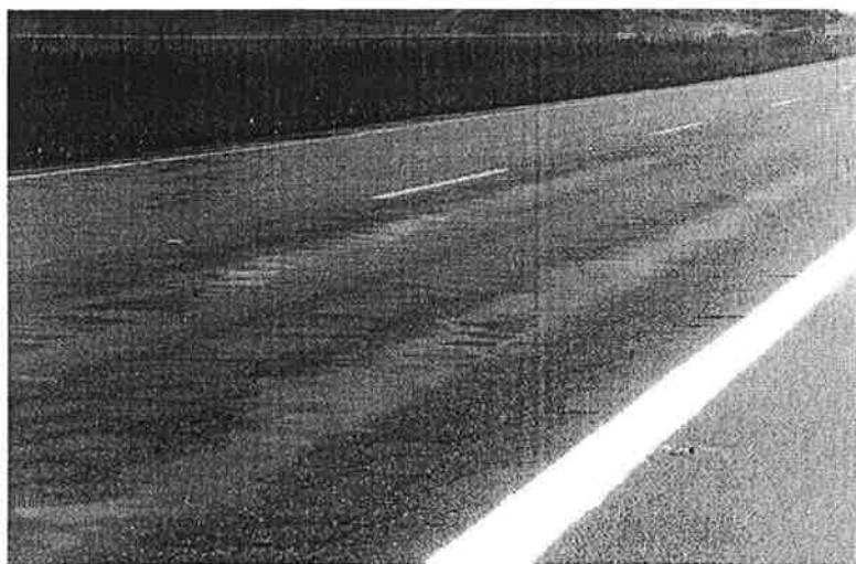
(b) Trilhas de roda em rodovia paulista na faixa de tráfego de veículos pesados
