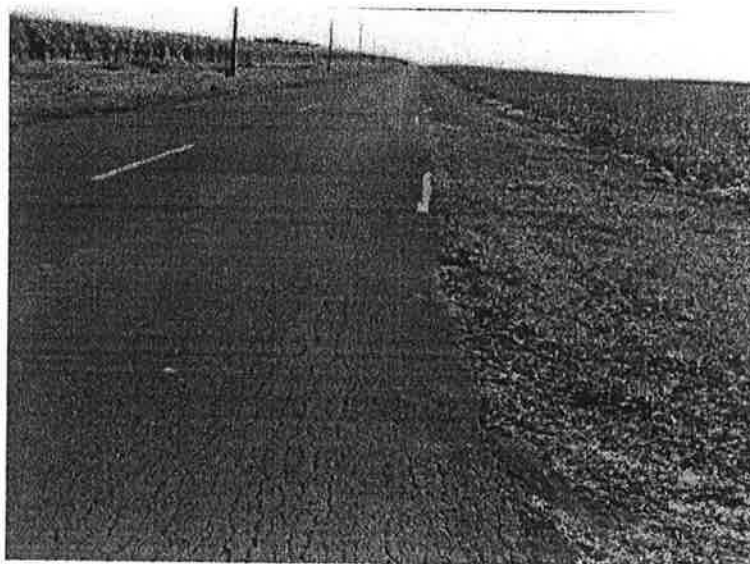
Figura 21: Trincas longitudinais em pavimento com base construída com solo laterítico, decorrentes de variação de umidade devido à infiltração d'água pelos acostamentos não impermeabilizados (Bernucci et al, 2000).
