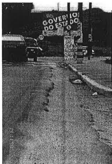
(a) “escorregamento” do revestimento asfáltico em pavimento urbano paulistano
